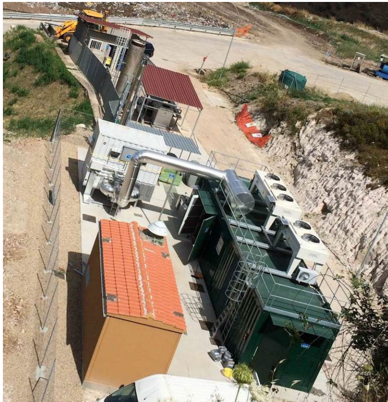
Figura 5: Impianto produzione energia elettrica – Vista dall'alto
